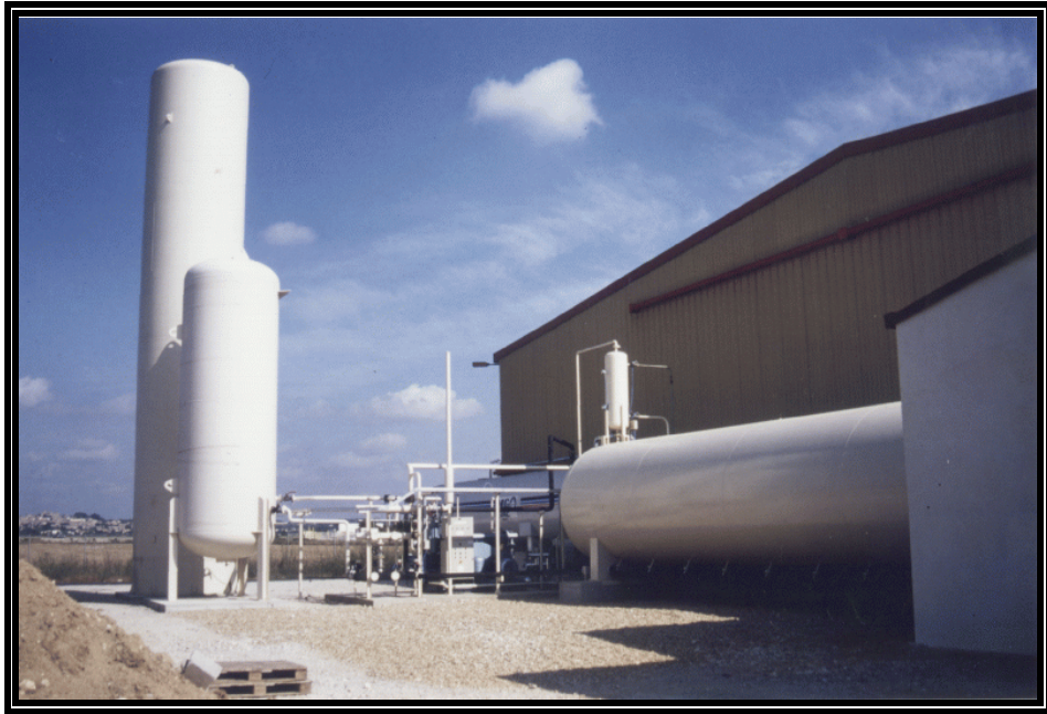
Figure 2. Autoclave de fumigation au CO 2 hyperbare avec réservoirs de recyclage du gaz.
