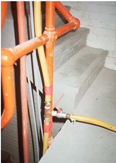
Le tuyau du CO 2 dans l'escalier et dérivation vers l'étage.
